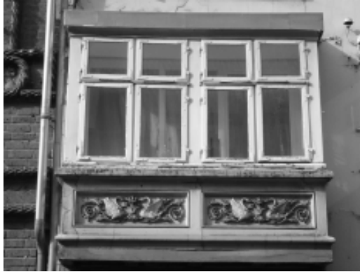
Abb. 2: Hervorragend erhaltene Schwanenornamente. Der Erker bedarf dringend einer Restaurierung
