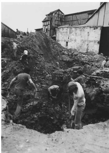
Auf dem Meere 34/35 nach dem Abriss, Foto K.E. Giesecking
