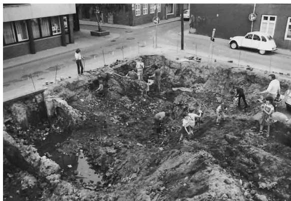
Auf dem Meere 34/35 nach dem Abriss, Foto K.E. Giesecking
